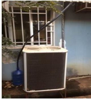
Figura 1: Condensadora de Ar Condicionado com o Dreno.
